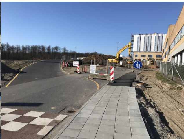
Etablering af ankomstvej i forbindelse med klargøring til ny parkeringsplads og renovering af hovedindgang A.
