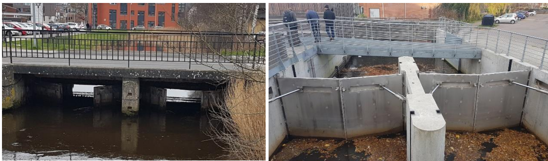
Slusen i Hobro med selvluukkende porte uden styring og til højre den motoraktiverede sluse på omløbsåen i Vejle
