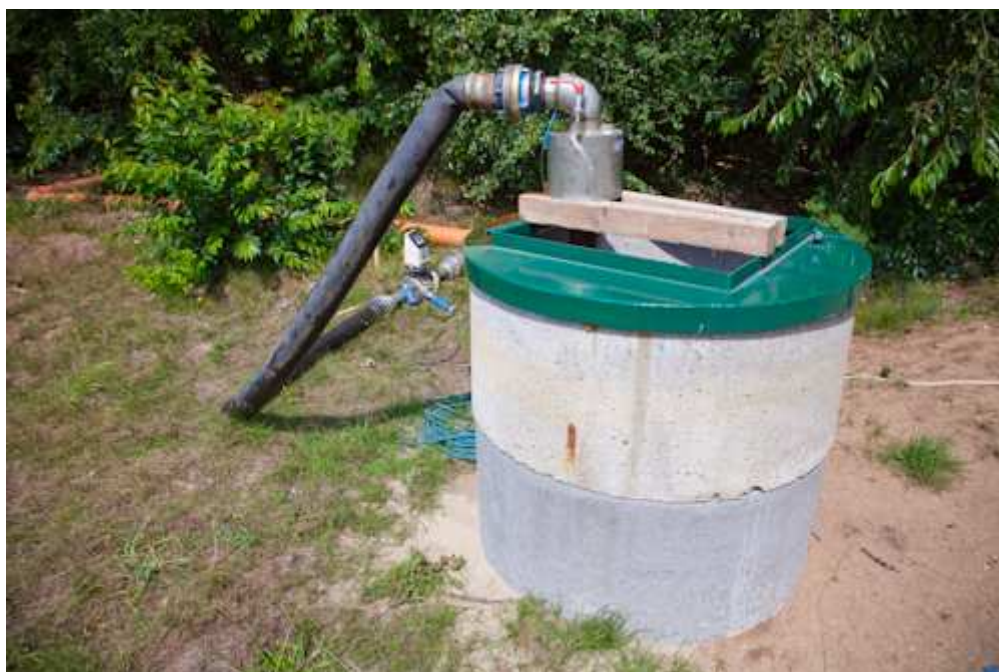
Figur 2.2: Pumpeboring (DGU nr. 114.2038) fotograferet under pumpning i juli 2009. Vandet ledes i slange til flowmåleren og herefter i faste orange rør.
